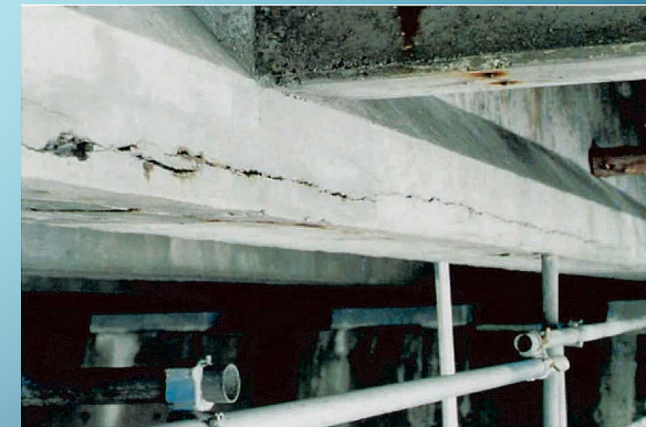
図 2.2 PC 上部工主桁の塩害事例
