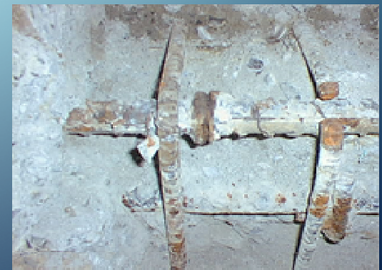
図 2.5 ASR 劣化による鉄筋破断事例 2-5)
