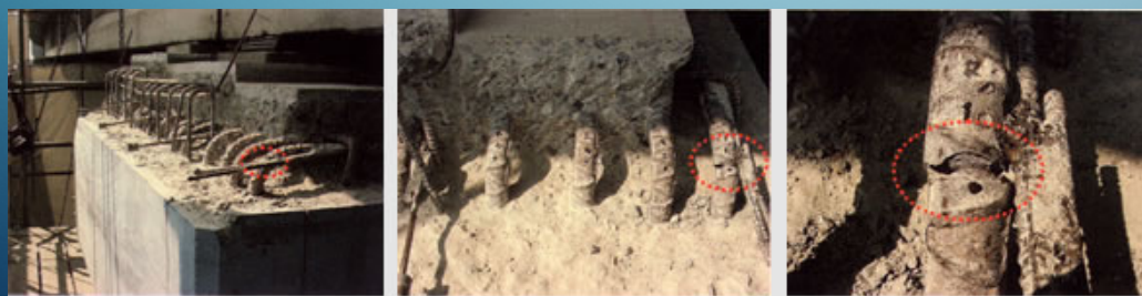
主鉄筋定着端折曲げ部の破断
