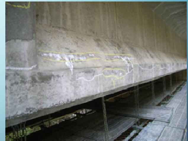
PC主桁のグラウト不良による ひび割れ発生事例
