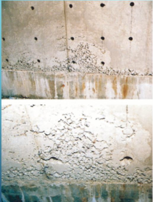
外壁下部の豆板
