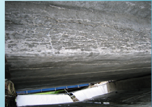
図 2.4 PC 上部工における ASR 劣化事例
